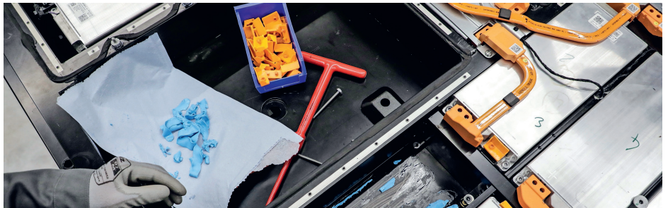
Avant d'installer un nouveau module de batterie, il faut éliminer les résidus de pâte thermique et appliquer de la pâte fraîche. Pour le dosage, il ne faut utiliser que la quantité nécessaire de ce produit coûteux et s'assurer que le fond de la batterie en est intégralement recouvert. Photos: Porsche
